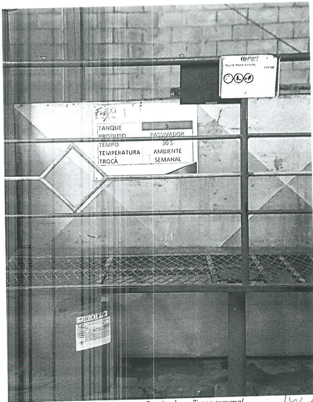
Figura 06: Tanque Passivador – Troca semanal.
