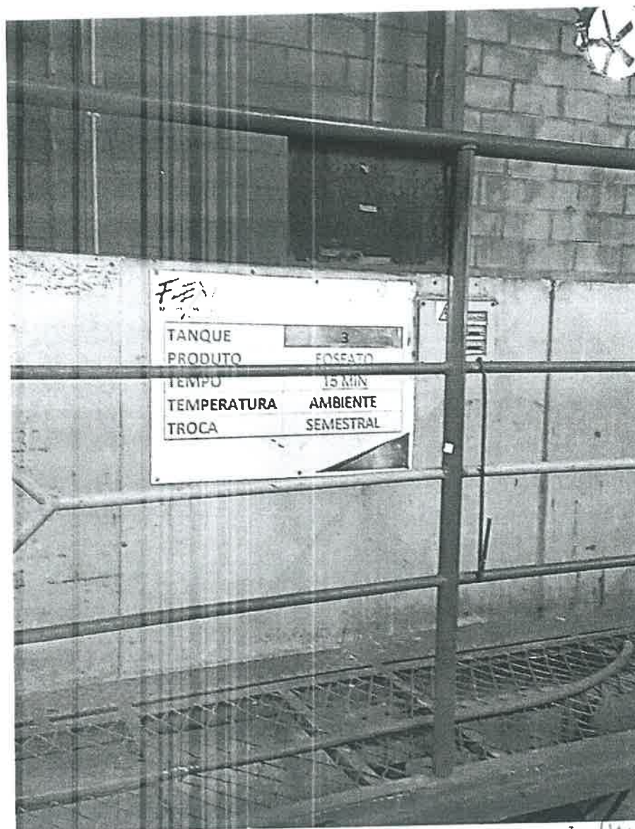
Figura 04: Tanque de Fosfato – Troca de insumo semestral.
