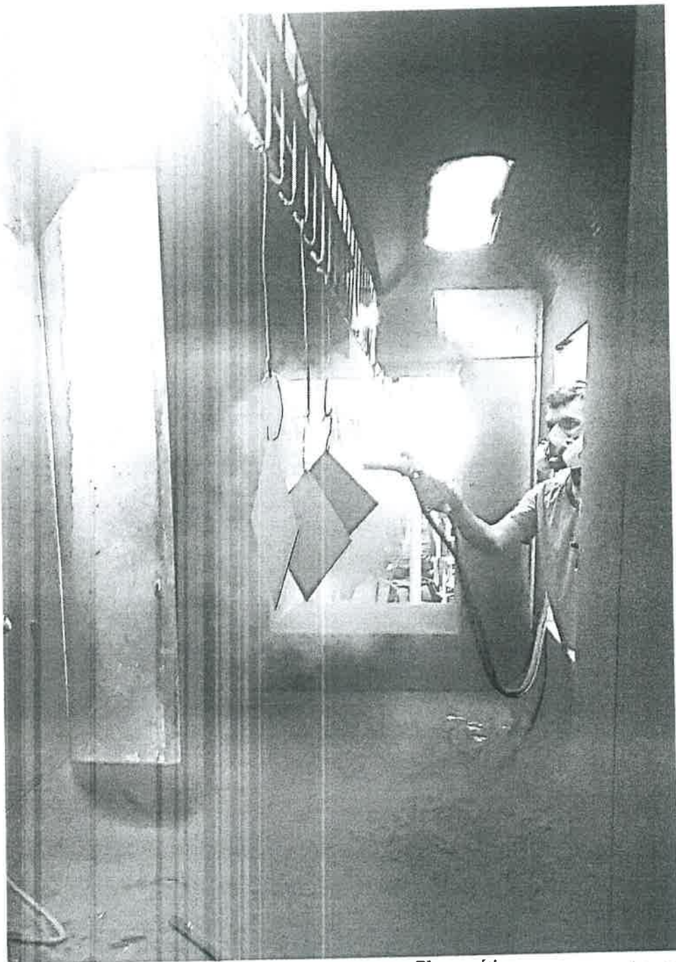
Figura 08: Cabine de Pintura Eletrostática
