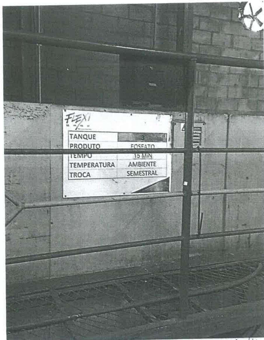
Figura 04: Tanque de Fosfato – Troca de insumo semestral.
